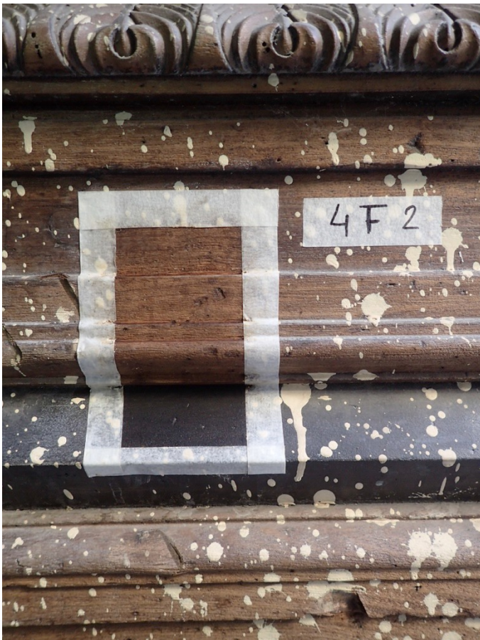
fusteria: cara exterior de la porta principal, ja decapada totalment i tacada amb pintura. Mostra fustes nobles com la Caoba.
