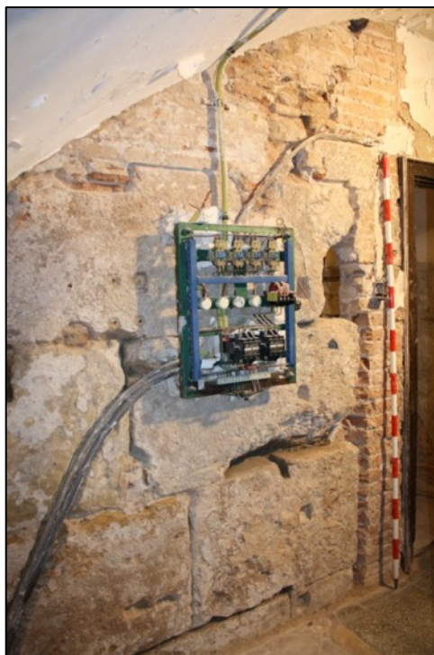
Fotografia 209. Lateral occidental torre 49 força afectat per instal·lacions elèctriques.
