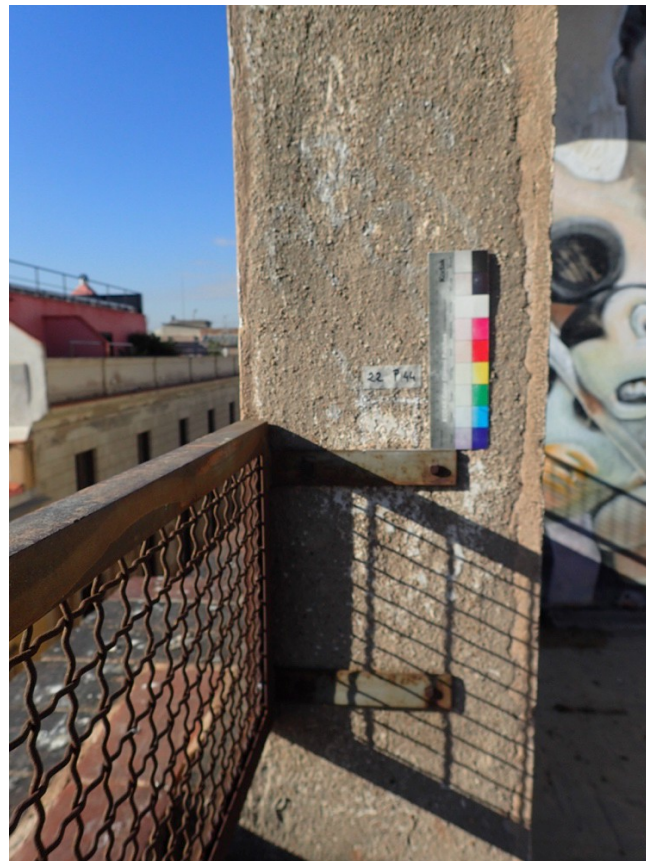
Revestiment original molt erosionat on no més es veuen les cantonades mestres i el morter d'enfoscat.
