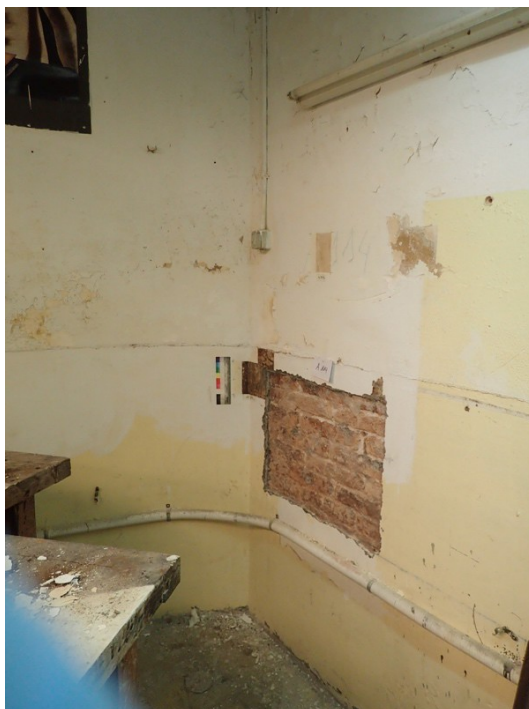
Sòcol afectat per humitats revestit amb morters de ciment Portland
