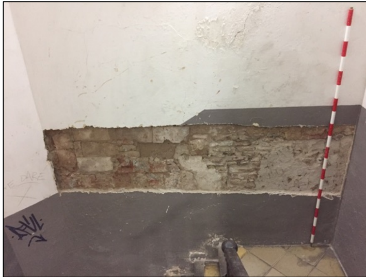
Fotografia 169. Cala AA2 oberta en el lateral de l'escala en la zona de l'entresol. Parament d'època contemporània UE2003.
