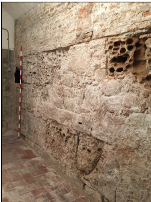
Fotografia 206. Vista general del frontal de la torre 49 amb les nombroses afectacions posteriors.
