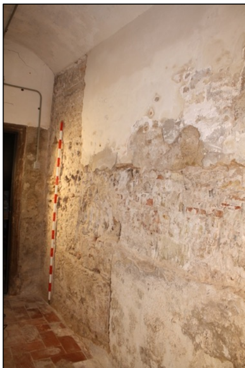
Fotografia 158. Tram de la torre 49.
