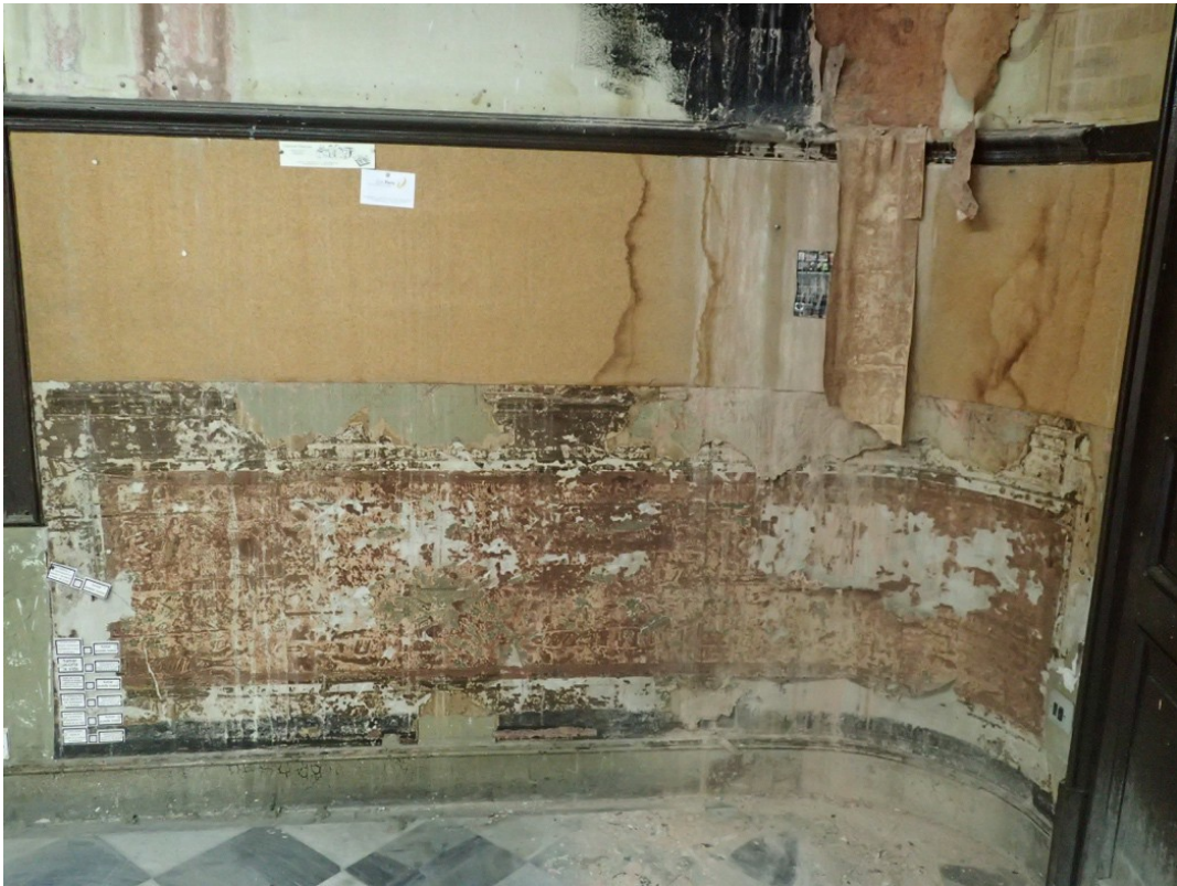
Parets: restes de papers pintats de l'època de construcció del Borsí.
