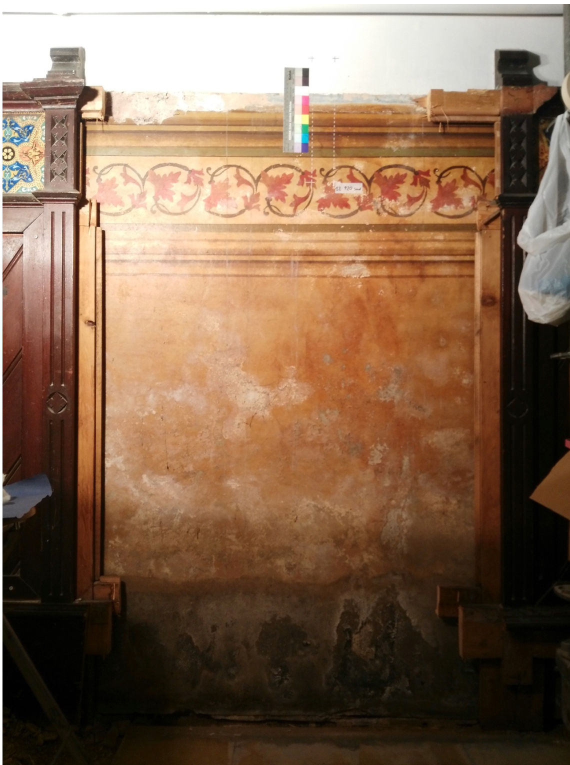
Sòcol ornamental pintat damunt d'enlluït de morter de ciment Portland, com solució d'humitats de capil·laritat.
