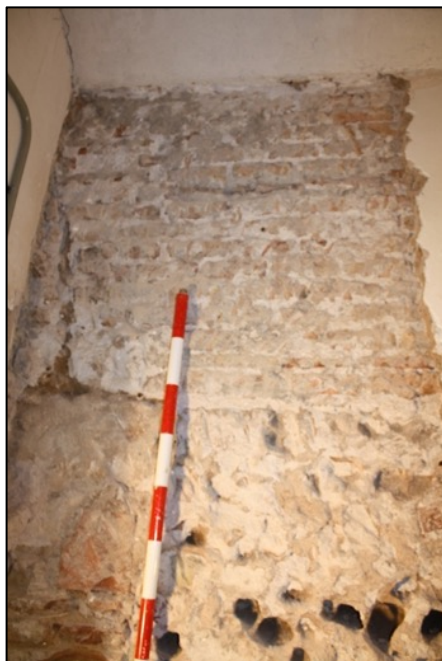
Fotografia 163. Vista del tram de maons documentat en la cota superior de la cala AA1 en la planta baixa.
