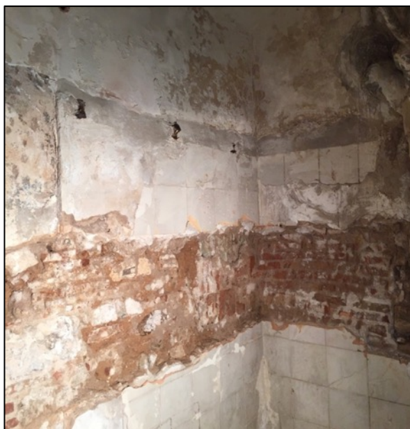
Fotografia 155. Detall zona amb rajoles UE1003 i reparacions modernes del mur.
