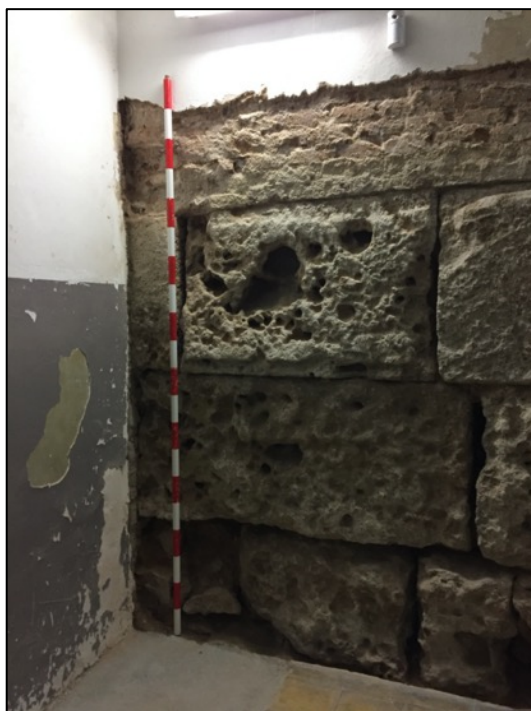
Fotografia 261. Detall dels carreus erosionats.
