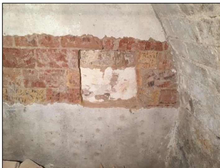
Fotografia 174. Enlluït que cobreix parament torre 48, UE2006.
