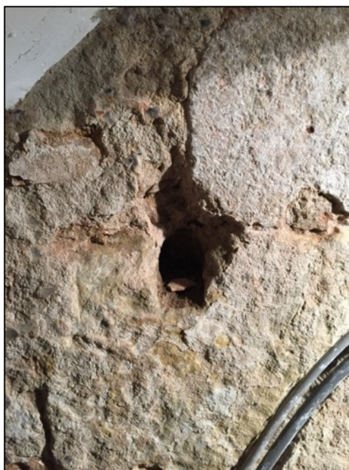
Fotografia 219. Orifici en uns dels carreus de la torre amb restes de la reparació del segle XVI. Es documenta una ceràmica reflex metàl·lic.
