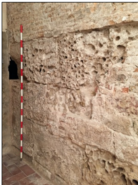
Fotografia 202. Vista de la important erosió que pateixen els carreus de la torre 49.
