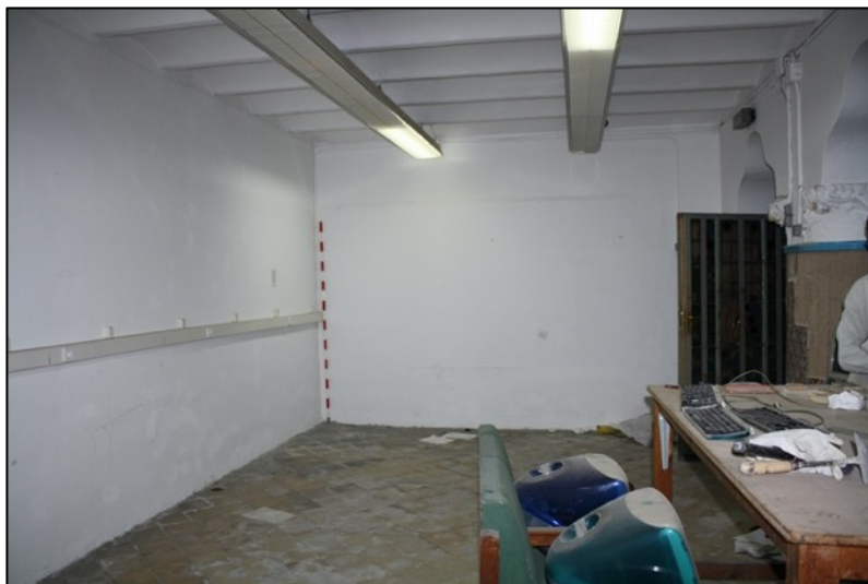
Fotografia 265. Vista del tram de parament actual de la torre 48 a la zona de l'entresòl
