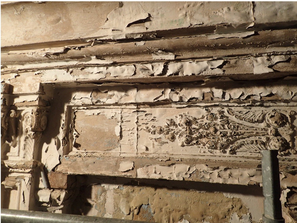
Guixos i capes pictòriques afectats per mecanismes de degradació per filtracions i retenció d'aigua pluvial.
