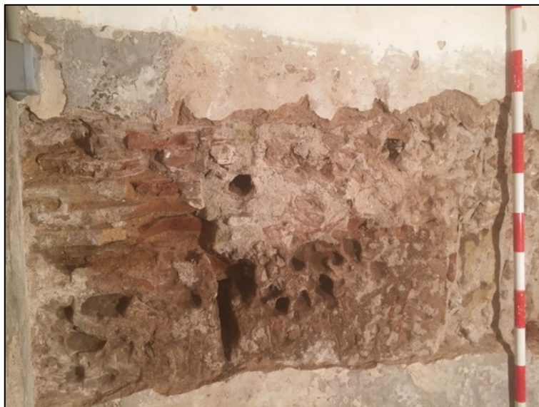
Fotografia 160. Vista de l'estat d'erosió d'alguns carreus de la muralla.
