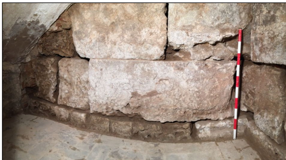
Fotografia 250. Vista de l' opus quadratum amb estats de conservació diversos dels carreus.
