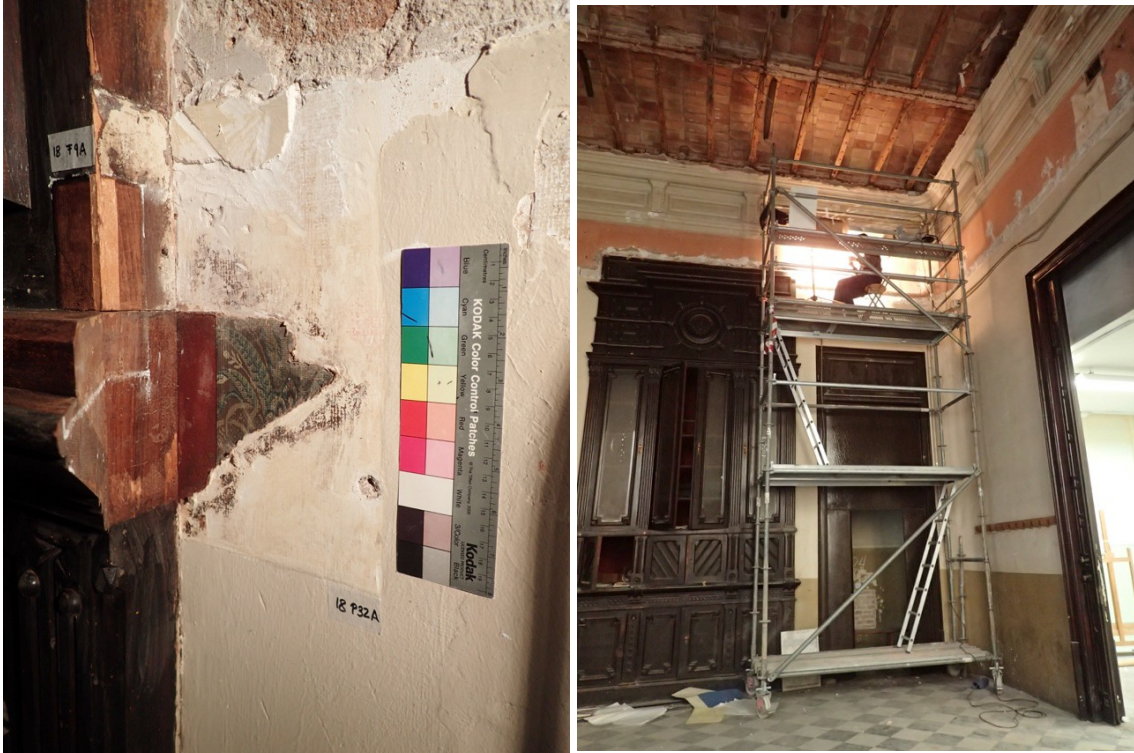
Restes del paper pintat original conservada darrera de una part de la cornisa de la llibreria adossada a la paret
