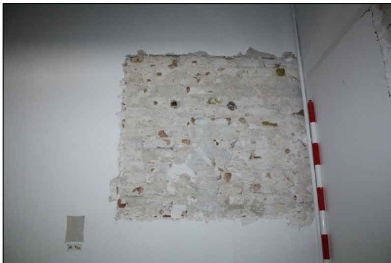
Fotografia 287. Detall de la cala parietal amb la documentació del mur mitger amb la finca Palau 4 UE3003 construït a mitjans del segle XIX.
