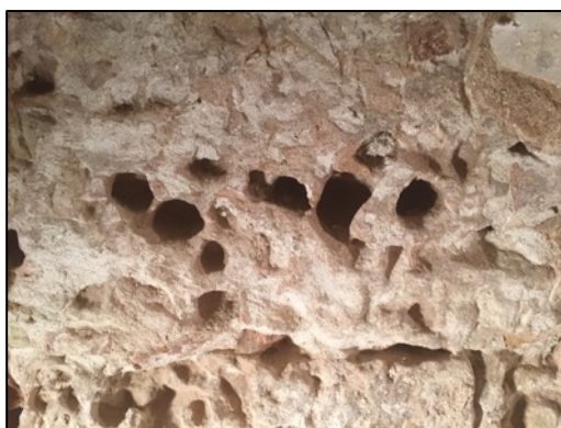
Fotografia 161. Detall de l'erosió dels carreus torre degut al salitre.
