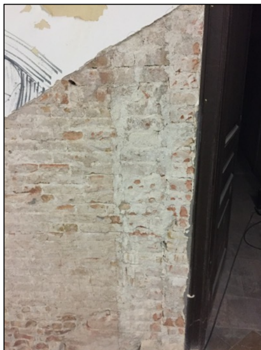
Fotografia 276. Cantonada tram escala a l'entresol amb mur aixecat al construir la finca de Plau 4 UE1020 amb el mur UE1021 relacionat amb la construcció del Borsí.
