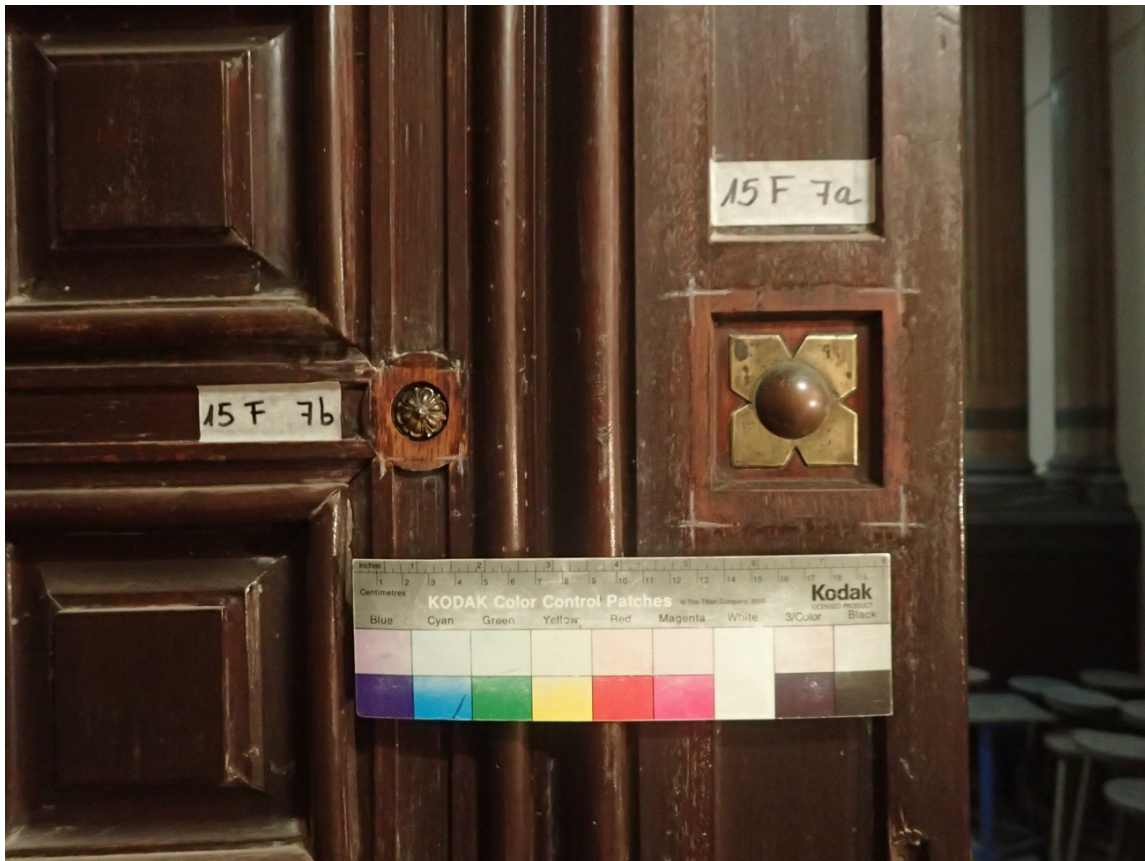
Fusteria: portes de fustes de alta qualitat (abunda la fusta de noguera) amb reblons i claus ornamentals de llautó.
