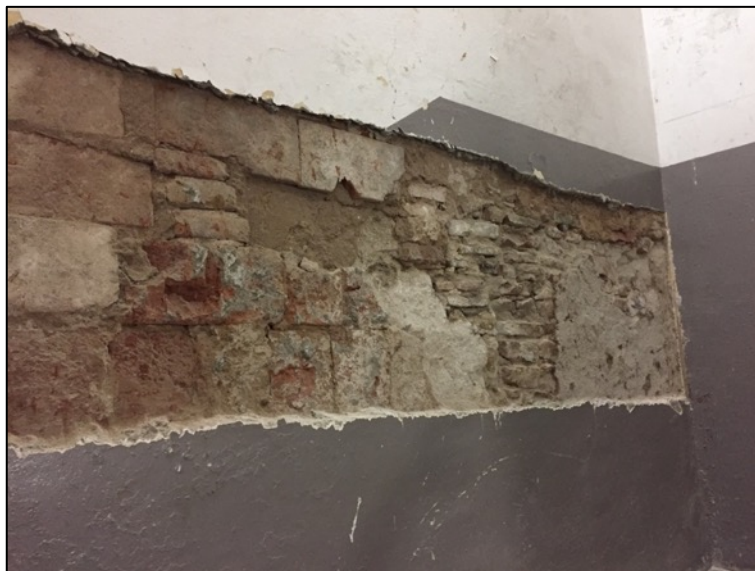
Fotografia 170. Detall del mur construït amb aplacat de maons i ciment i restes de maons amb morter de calç.
